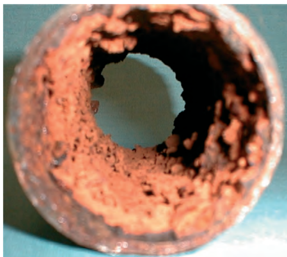
Foto 2. Corrosión en una tubería
